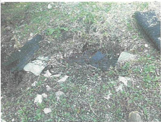
写真 3-20 壊れている集水桝
