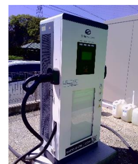
「自社EV車充電スタンド」
