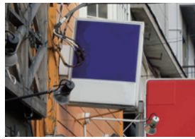
上部構造全体の傾斜、 ぐらつき
