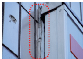
溶接部の劣化、コーキングの 劣化等
