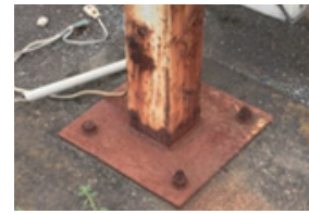
鉄骨のさび・ 塗装の老朽化
