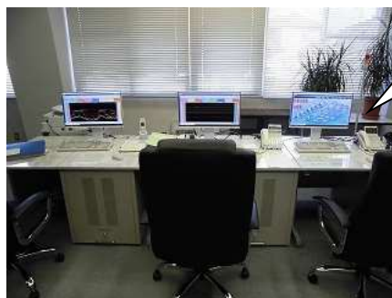
計装室 (中央監視 制御装置)
