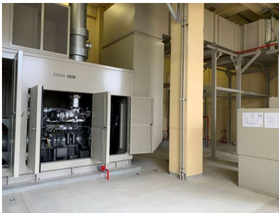
自家発電設備
