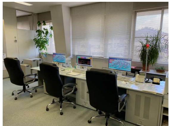
中央監視装置
