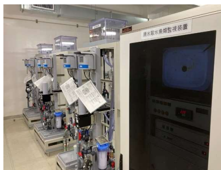
水質監視装置
