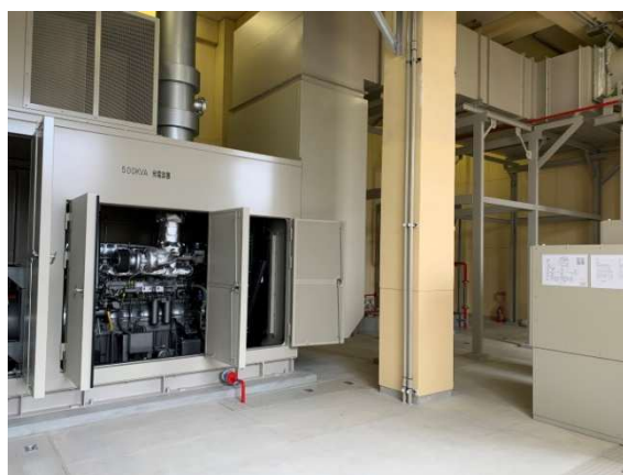
自家発電設備
