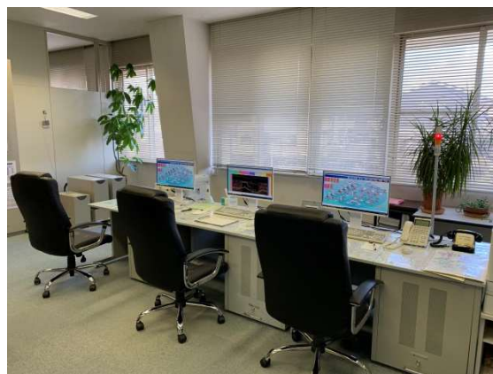
中央監視装置
