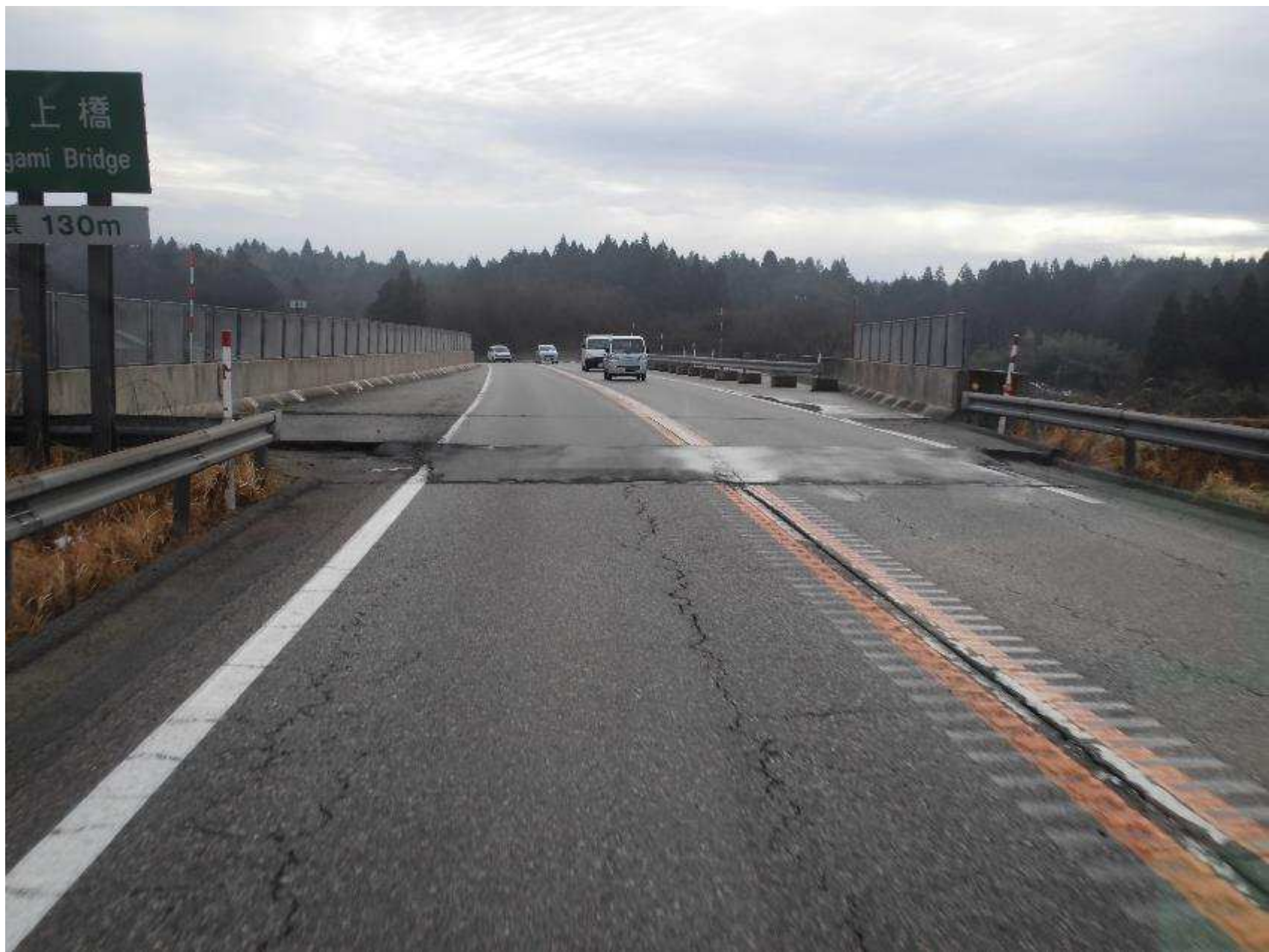
のと里山街道の段差
