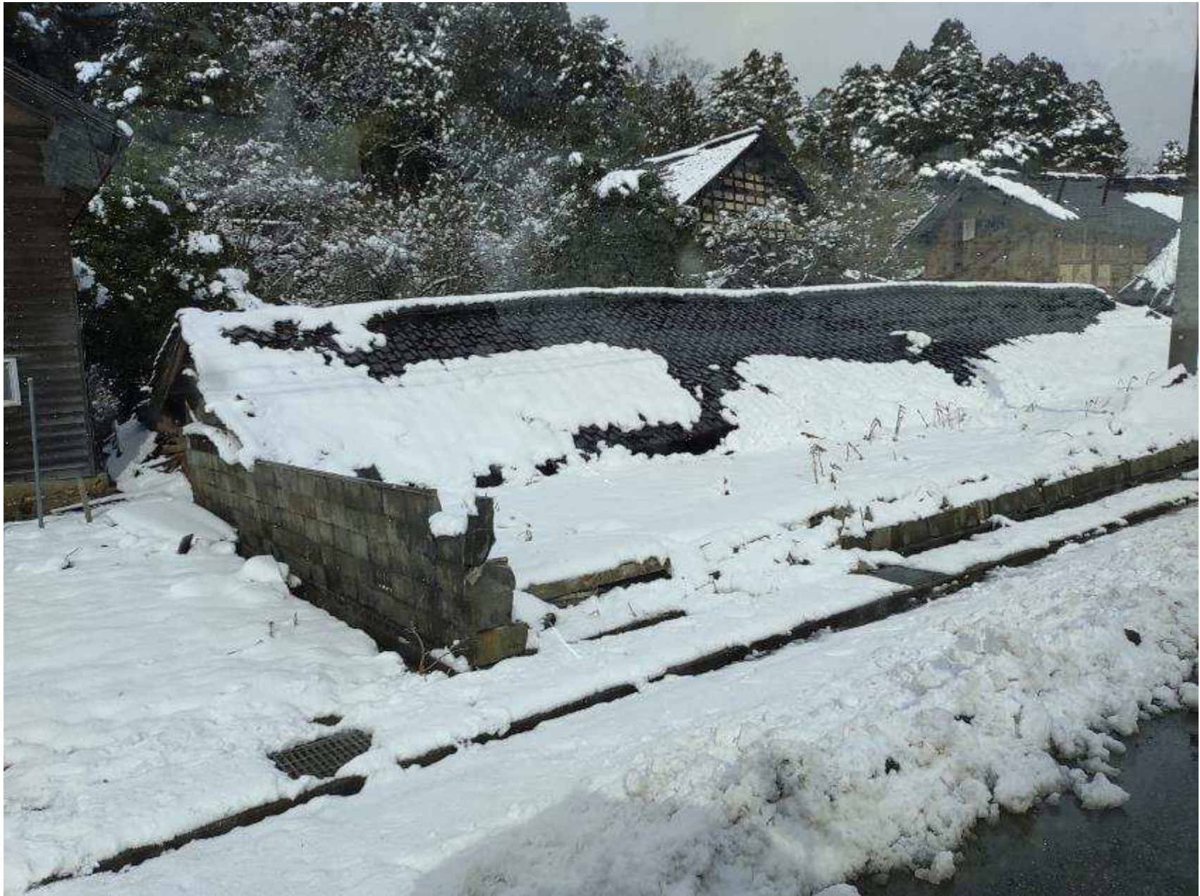
市内の地震被害の様子
