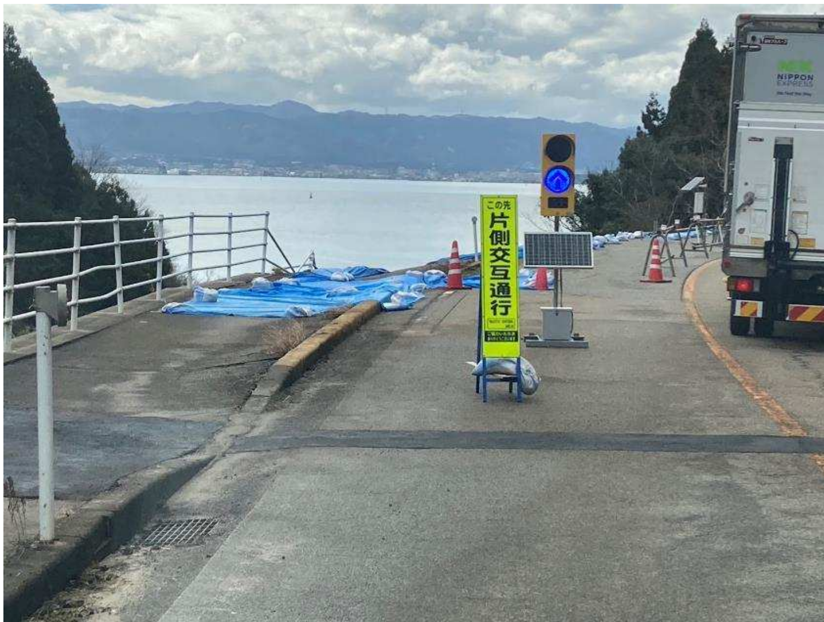
能登島の歩道被害の様子
