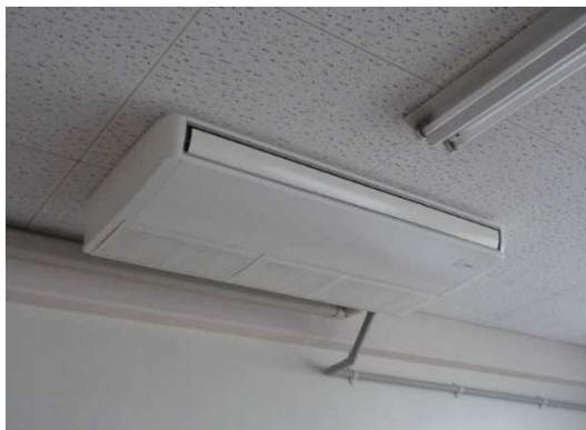
普通教室・特別教室の空調機
