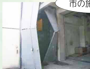
▲過去にあった事故によるごみ処理施設の破損
