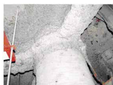
▲吹き付けられたアスベストの一例
