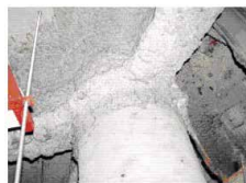
▲吹き付けられたアスベストの一例
