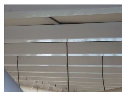
天井パッキンの剥がれ
