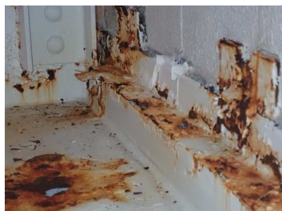
外壁留金物の錆による腐食
