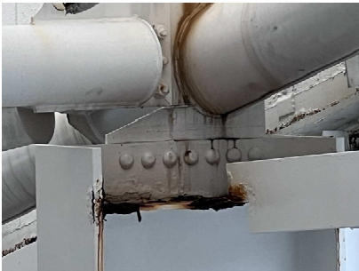
ガセットプレートの錆による腐食
