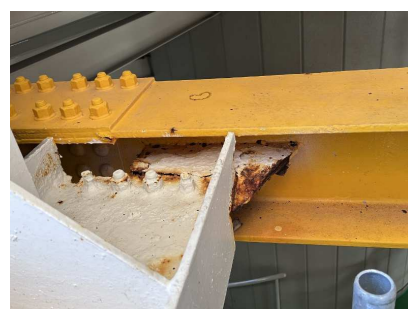
ガセットプレートの錆による腐食
