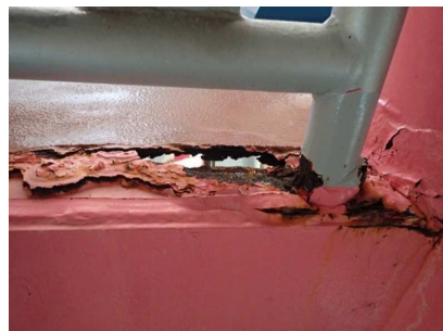
ブリッジ幕板の腐食による床面の穴
