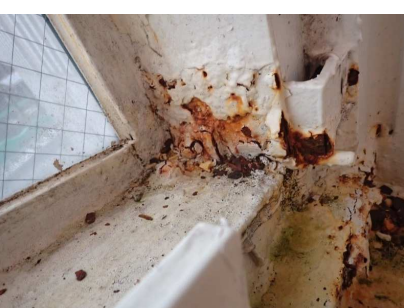
窓枠の錆による腐食
