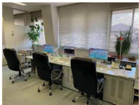
中央監視装置
