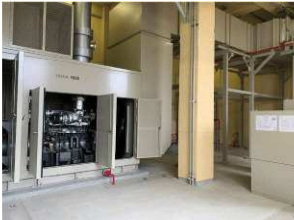
自家発電設備
