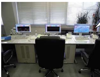
計装室 (中央監視 制御装置)
