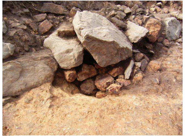
写真4 S区 石垣Ⅱ 崩落部分
