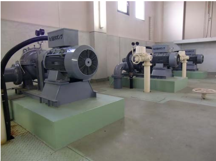
送水ポンプ 管理棟内にあり、桃花 台高架水槽へ水を送 る。 (平成22年11月撮影)
