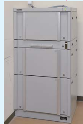
回線制御装置
