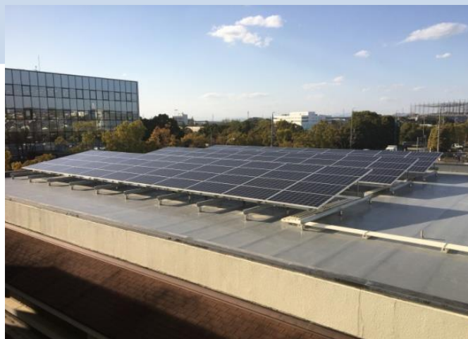
勤労センターの太陽光発電システム
