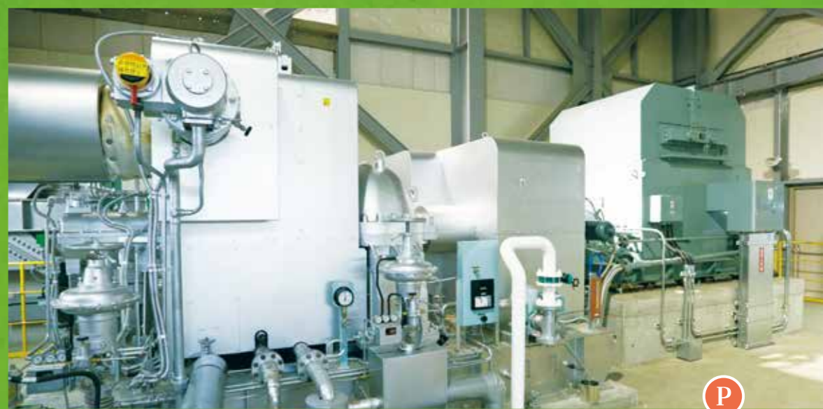
P 蒸気タービン・発電機 ボイラで作られた蒸気を利用して発電します。蒸気により蒸気タービン内の羽根(ブレード)を回転させ、その回転が発電機に伝わり、電気が発生します。
